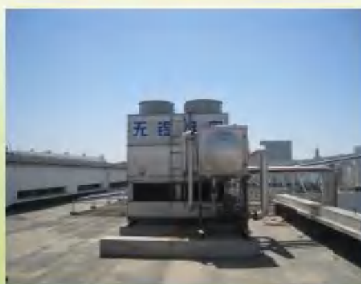
用于PET400线直接冷却的水塔
